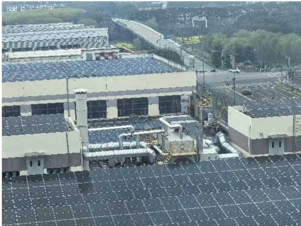
图 3-2 废气处理设施
