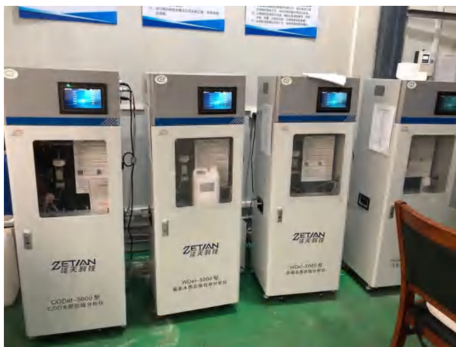
图 3-5 废水总排口在线监测设备（COD、氨氮、总磷、总氮）
