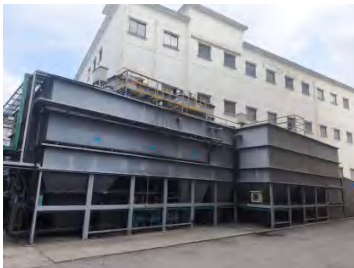
图 3-4 废水处理设施
