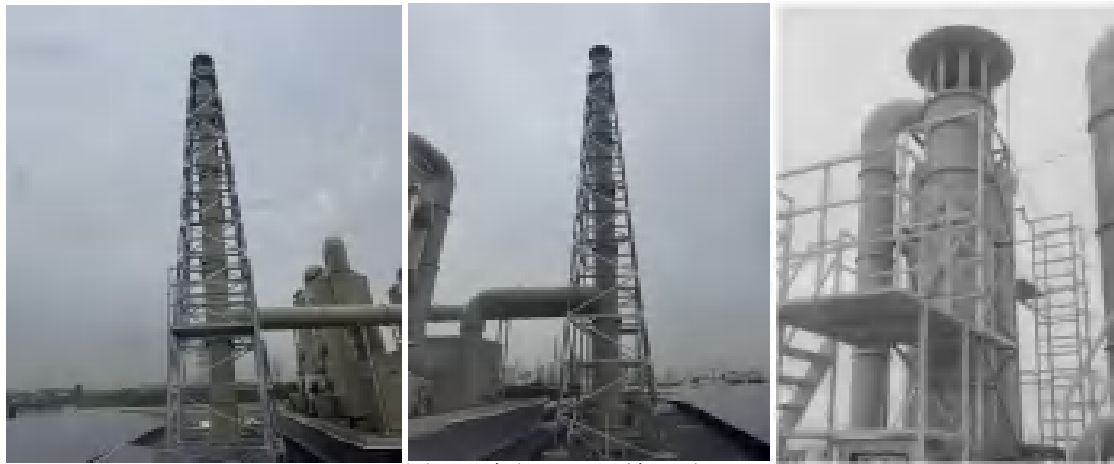
图 3-4 废气处理设施照片
