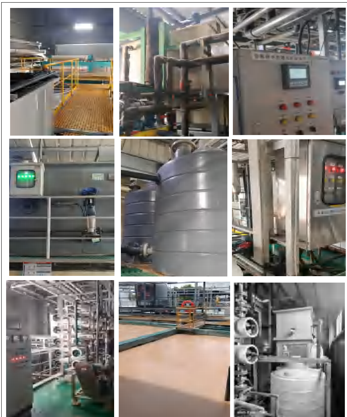
图 3-2 水处理站现场照片
